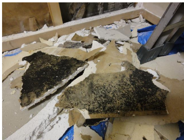
石膏ボードの撤去。裏側は、カビで真っ黒。
