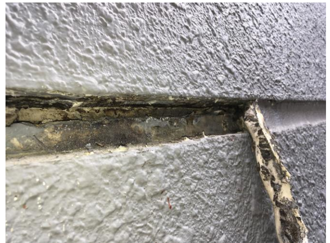
シーリングの裏側まで黒くかびが生えていた。
