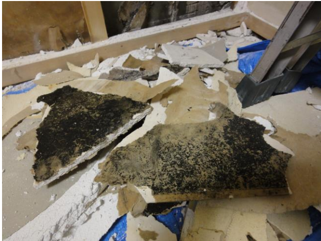
雨漏りと思しき壁を剥がしたらカビだらけ
