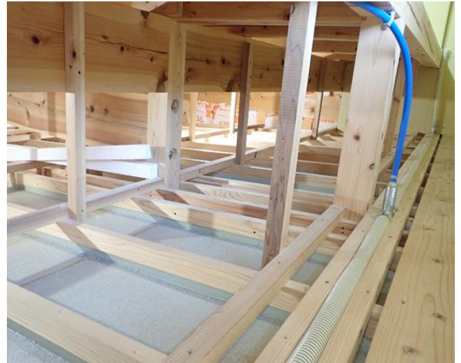
天井裏の冷熱パネル
