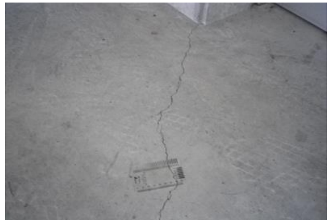
ビルトインガレージの床のクラック
