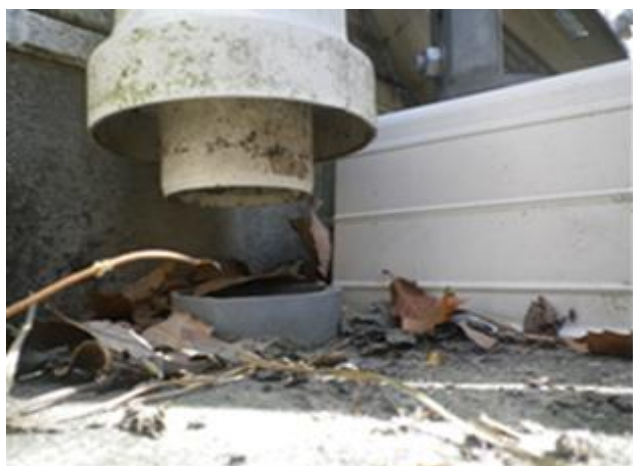
雨樋の接続不良
