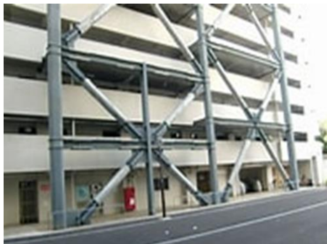
（株）耐震設計 HP より
